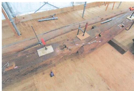
(解体時／隅木折損状況)
