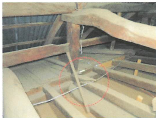
(調査時／小屋内の垂木折損部)
